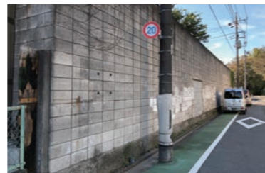
区内の通学路に残る危険なブロック塀
