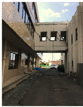
ひび割れした庁舎
