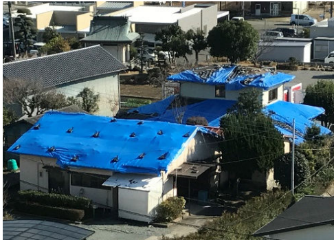
屋根瓦が落ちブルーシートで雨風を凌ぐ
