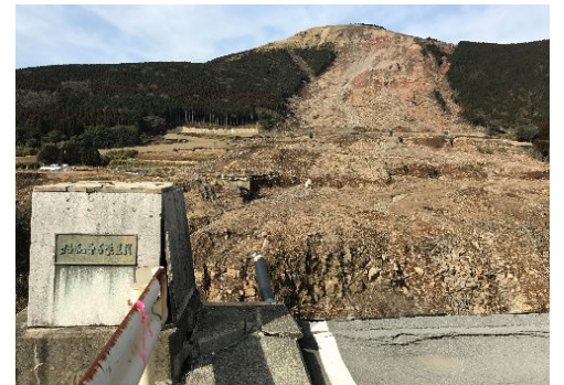
崩落した阿蘇大橋、被害の甚大さを感じる
