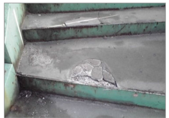
階段部分の破損部分
