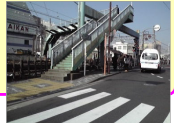
破損が進行している歩道橋
